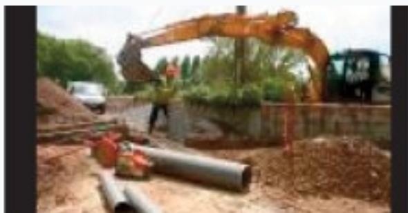
Le réseau public
